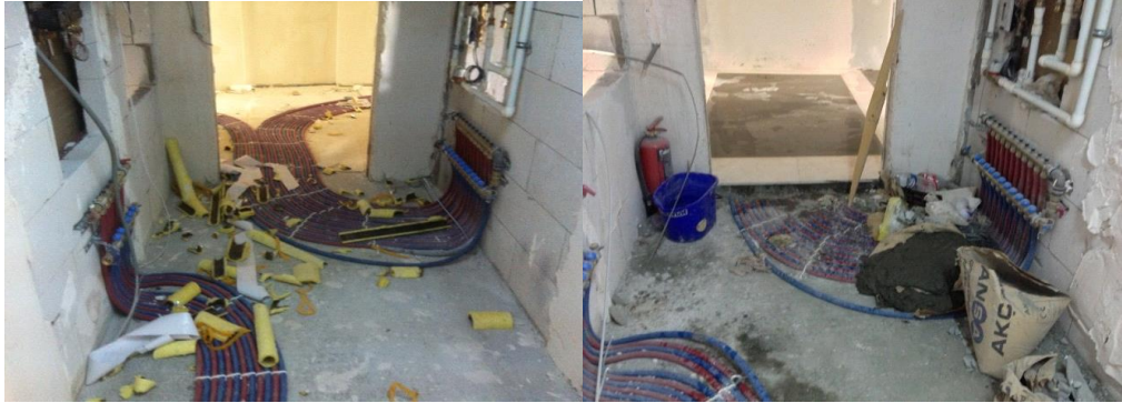
Şekil 4.5. Nisbetiye On Yerden ısıtma borularının dizilişi
