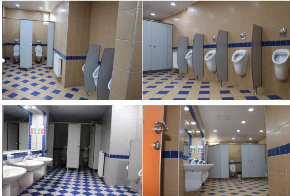
Foto 20. Ayazağa Işık İlköğretim Okulu lavabo ve WC bölümleri (URL,22).
