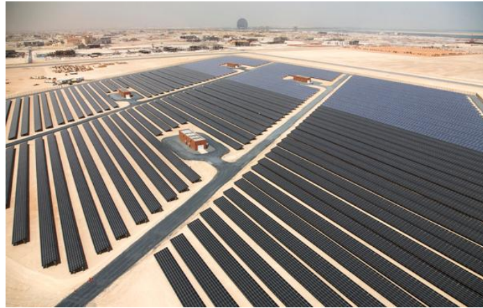
Şekil 3. 15 Solar PV Tesisi
