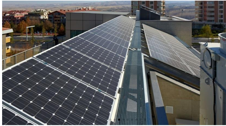
Resim 5.5. Güneş paneli uygulaması
