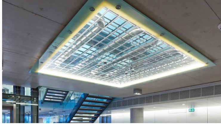
Resim 5.4. Soğuk kiriş uygulaması
