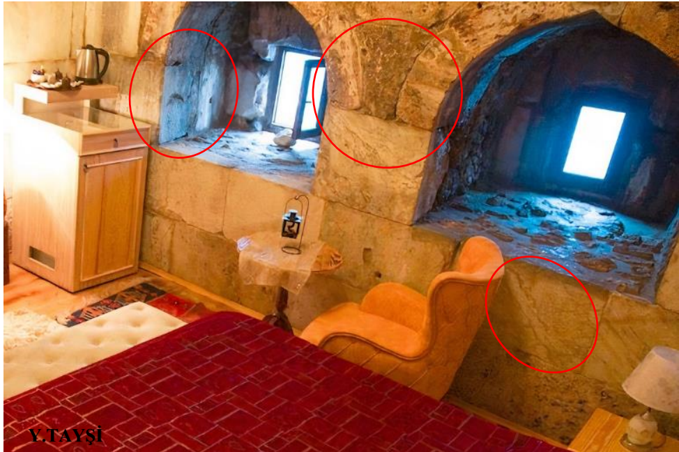
Resim 4.30. Otel odası pencere çevresinde görülen doğal bozulmalar
