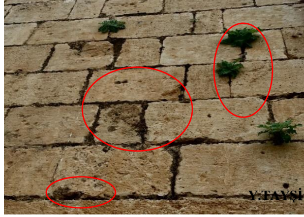
Resim 4.20. Mardin otel teras alanı duvarında görülen biyolojik ve fiziksel bozulmalar
