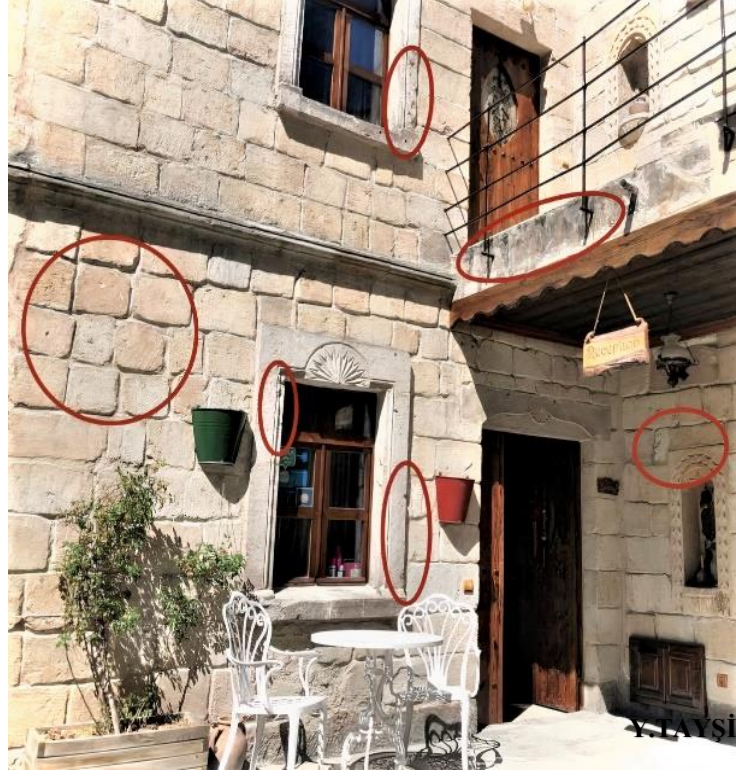
Resim 4.63. Otel dış mekan ortak alanlarındaki tüflerin kusurları
