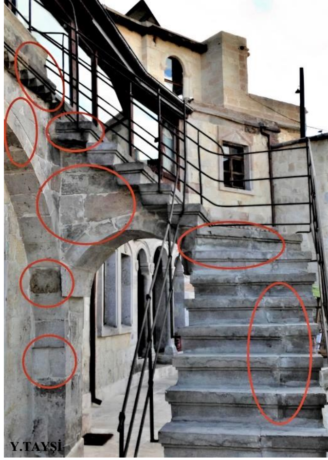
Resim 4.67. Avlu merdivenindeki tüflerin bozulma türleri ve yapay etmen kaynaklı kusurları
