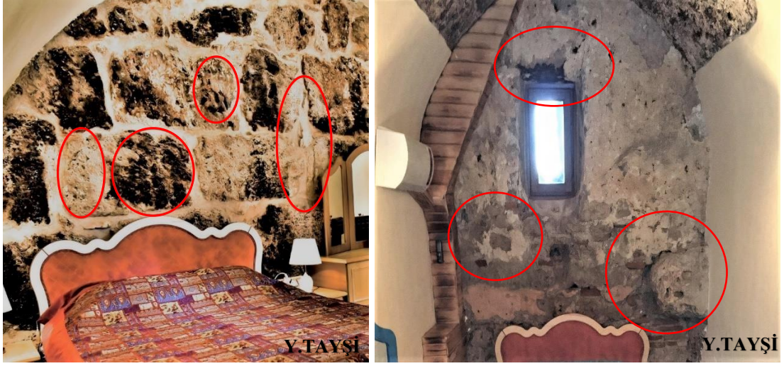
Resim 4.28. Yatak başının arkasındaki duvarda görülen doğal kaynaklı bozulmalar
