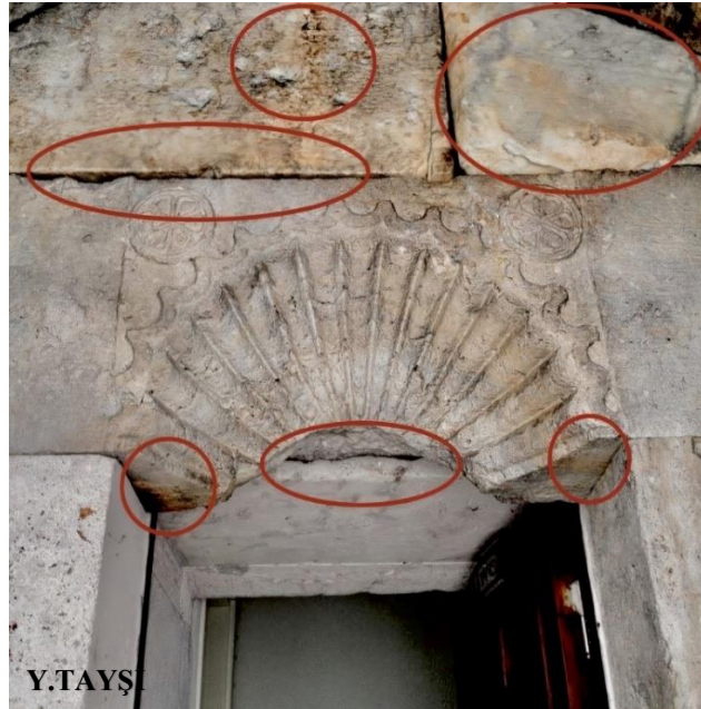
Resim 4.42. Otel avlusunda bulunan ortak alan tuvalet girişindeki traverten bozulmaları
