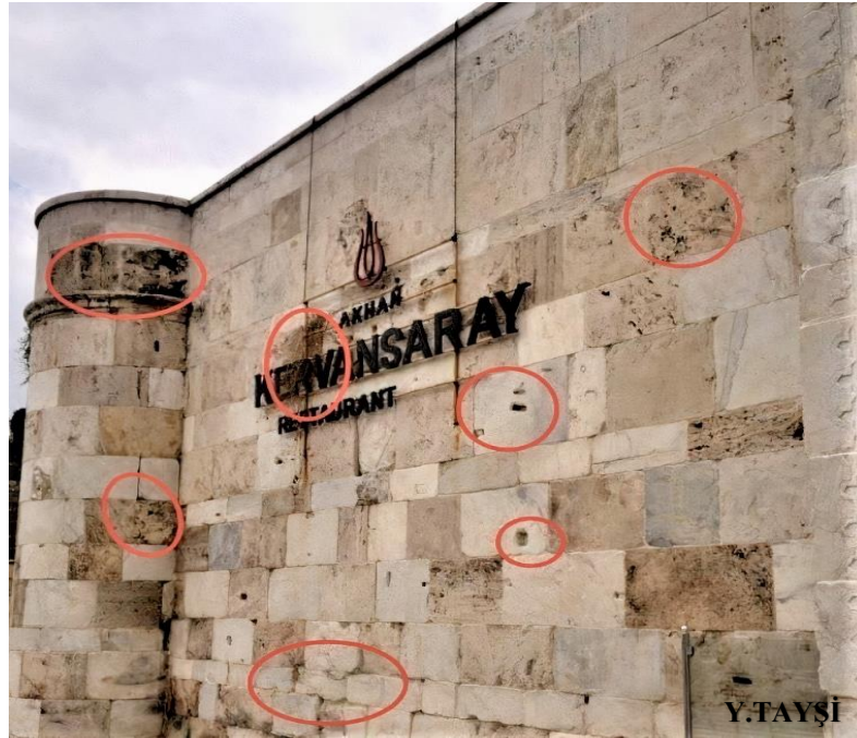
Resim 4.25. Denizli otel dış cephede görülen doğal bozulma türleri
