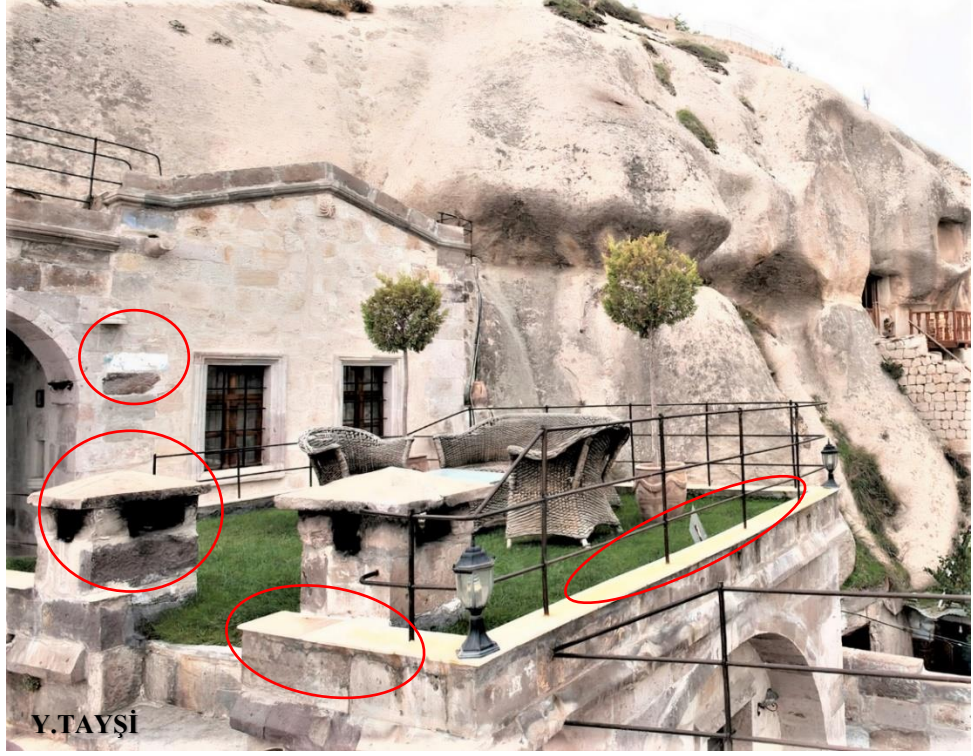
Resim 4.68. Otel dış mekan oturma alanındaki tüflerde görülen bozulmalar
