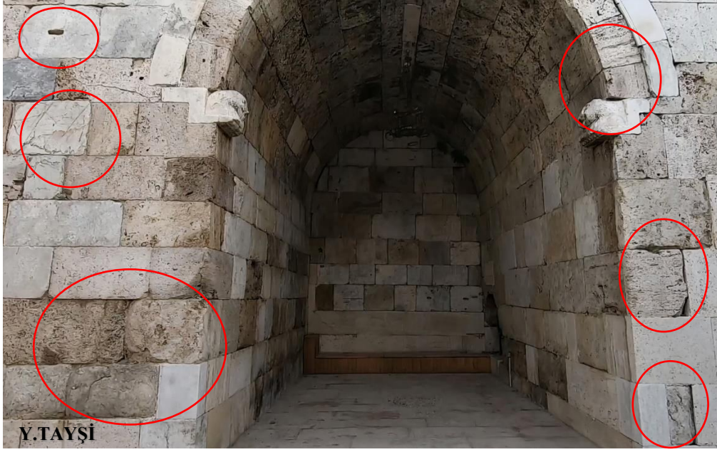
Resim 4.38. Otel eyvanında ve kemer çevresinde görülen bozulmalar
