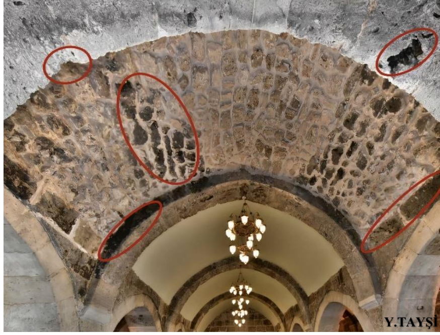
Resim 4.33. Restorant alanındaki çapraz tonozda ve kemerlerde görülen doğal bozulma türleri
