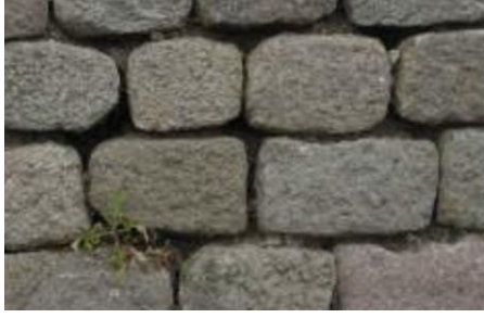
Resim 3.8. Taş duvarda derz boşalması
