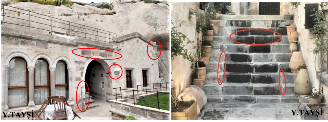
Resim 4.50. Otel girişinde görülen doğal kaynaklı bozulmalar
