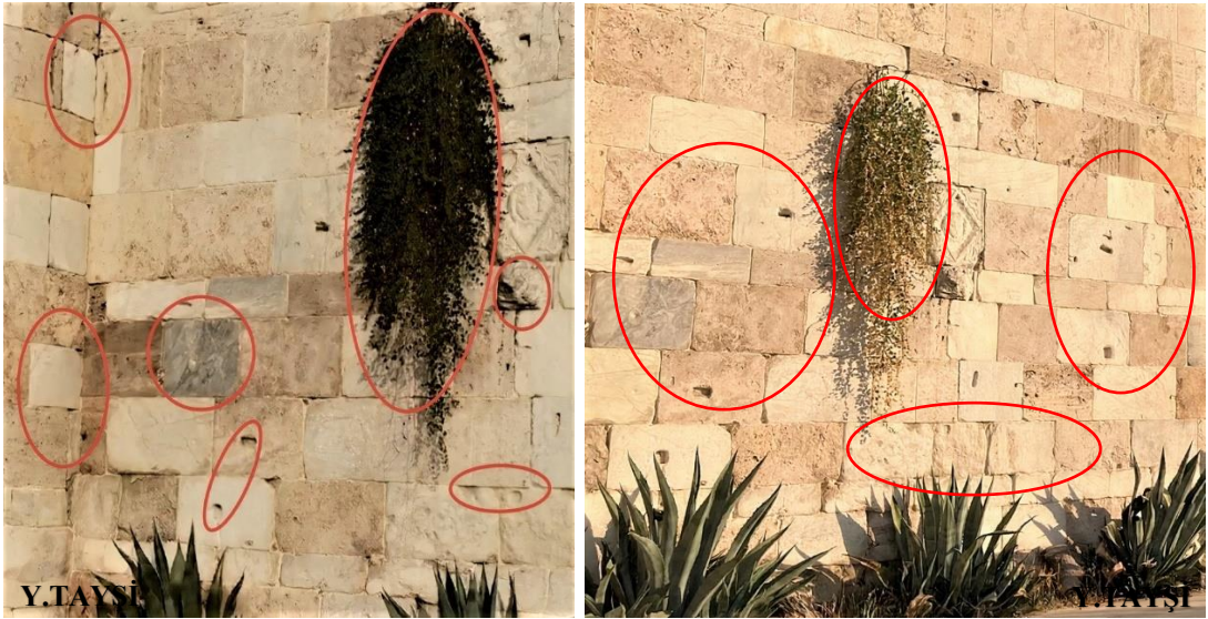
Resim 4.43. ve 4.44. Otel iç avlu duvarlarındaki travertenlerde görülen bozulma türleri
