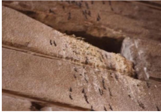
Resim 3.24. Taş yapıda kuş dışkılarının yarattığı bozulma
