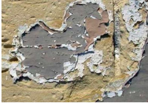
Resim 3.26. Hatalı boya-sıva uygulaması
