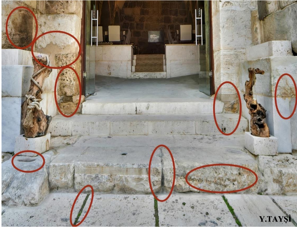
Resim 4.36. Otel restoran ve resepsiyon girişinde görülen doğal ve yapay kaynaklı bozulmalar
