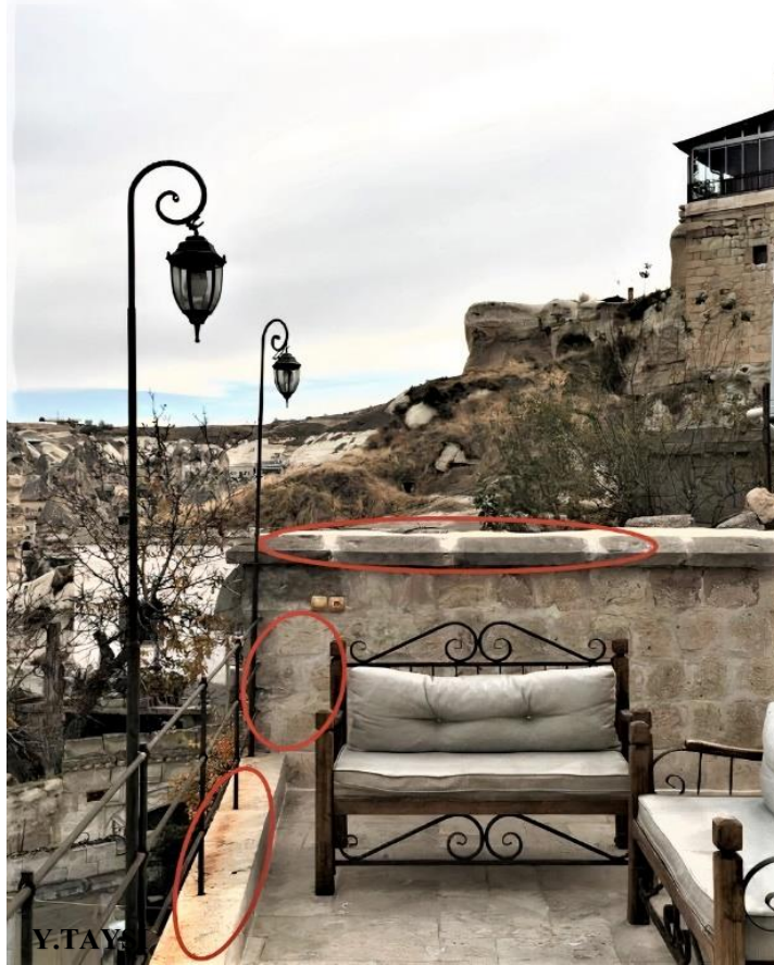
Resim 4.62. Otel oturma alanı çevresine görülen bozulmalar
