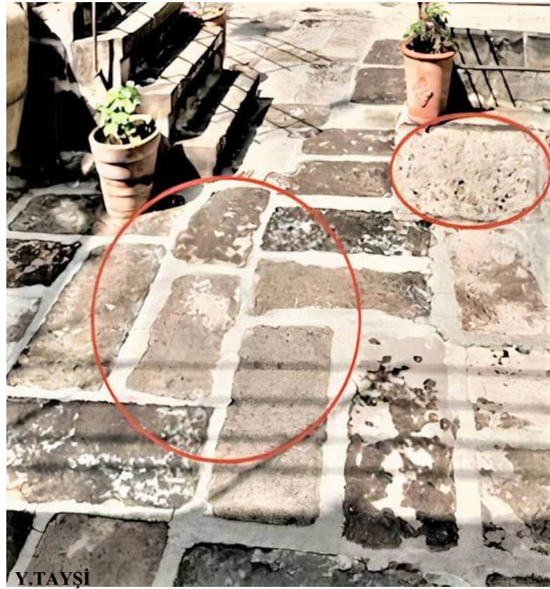
Resim 4.69. Ortak alan zeminindeki tüflerde görülen hatalı onarım kaynaklı kusurlar
