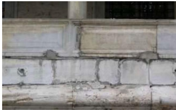
Resim 3.27. Hatalı onarım teknikleri ve yanlış malzeme kullanımı
