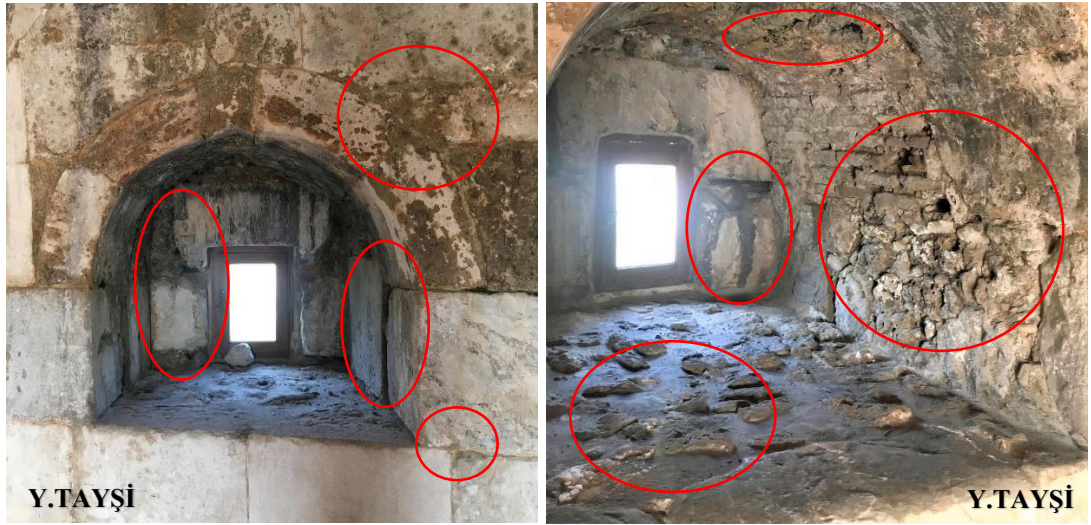
Resim 4.31. ve 4.32. Otel odası pencere etrafında görülen doğal ve yapay bozulmalar
