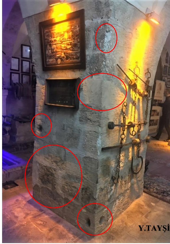
Resim 4.12a. Mardin otel lobi alanındaki kolonda görülen taş bozulmaları
