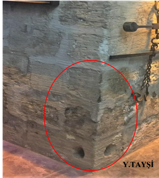
Resim 4.12b. Kolonda görülen yapay kaynaklı bozulmaların yakın çekimi
