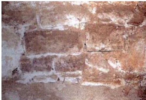
Resim 3.11. Taş yüzeyde tuzlanma
