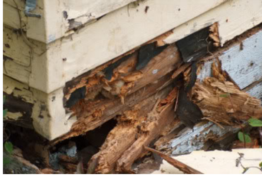
Resim 3.8. Su etkisinde kalmış ahşap malzemesi (URL 33)
